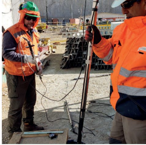
Instalación de inclino-extensómetro DEX-S, Mina Chuquicamata - Chile
