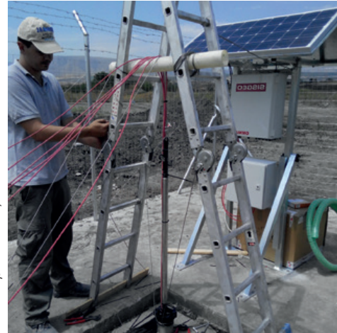
Instalación de inclino-extensómetro DEX-S, 150 m de profundidad, Mina Ptolemaida - Grecia
