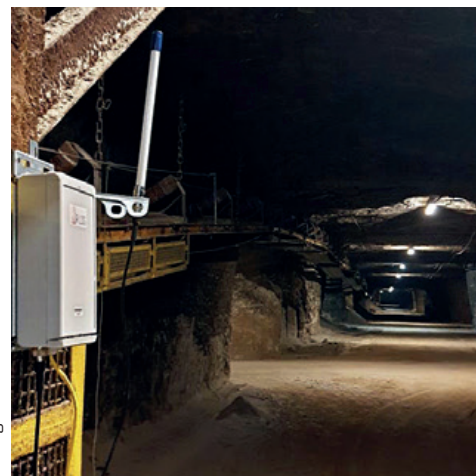
Instalación de WR-Log en la Mina de Salines, Varangéville - Francia
