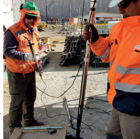
Instalación de inclino-extensómetro DEX-S, Mina Chuquicamata - Chile
