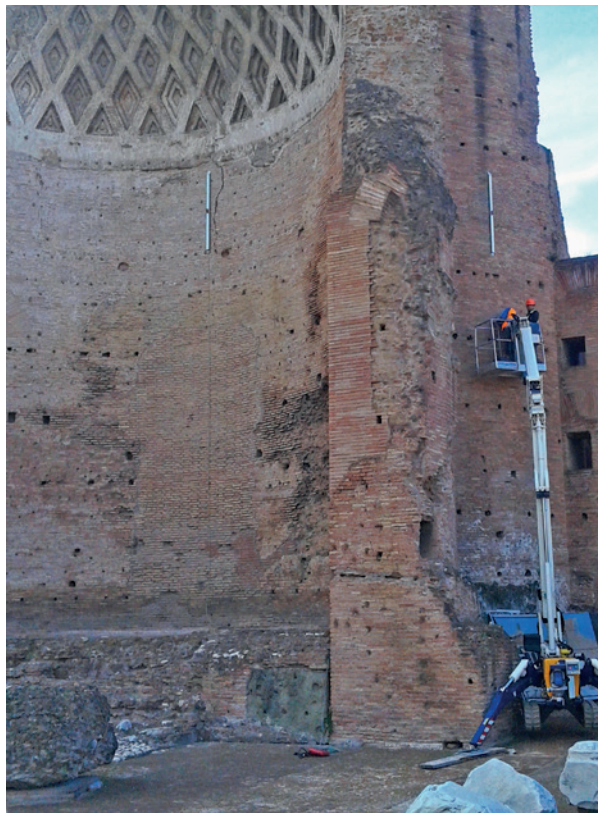
Installation de clinomètres à barre sur la basilique de Maxence
