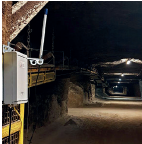
Installation WPR-Log dans la mine des Salines de L'Est à Varangéville, France
