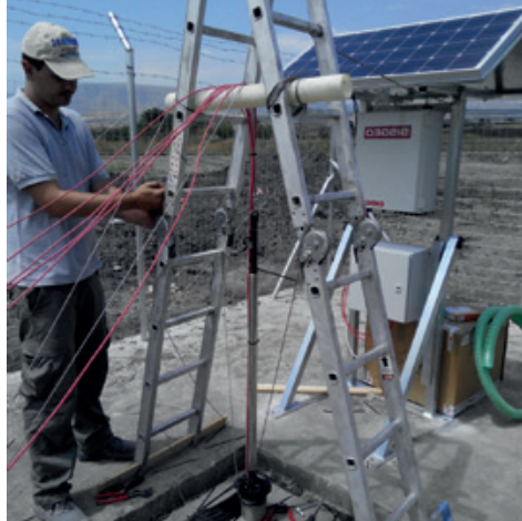
Installation inclin-extensomètre DEX-S, 150 mt de profondeur, dans la mine Ptolemaida, Grèce
